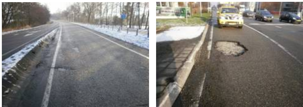
Figuur 8: Vorstschade op een provinciale weg.
